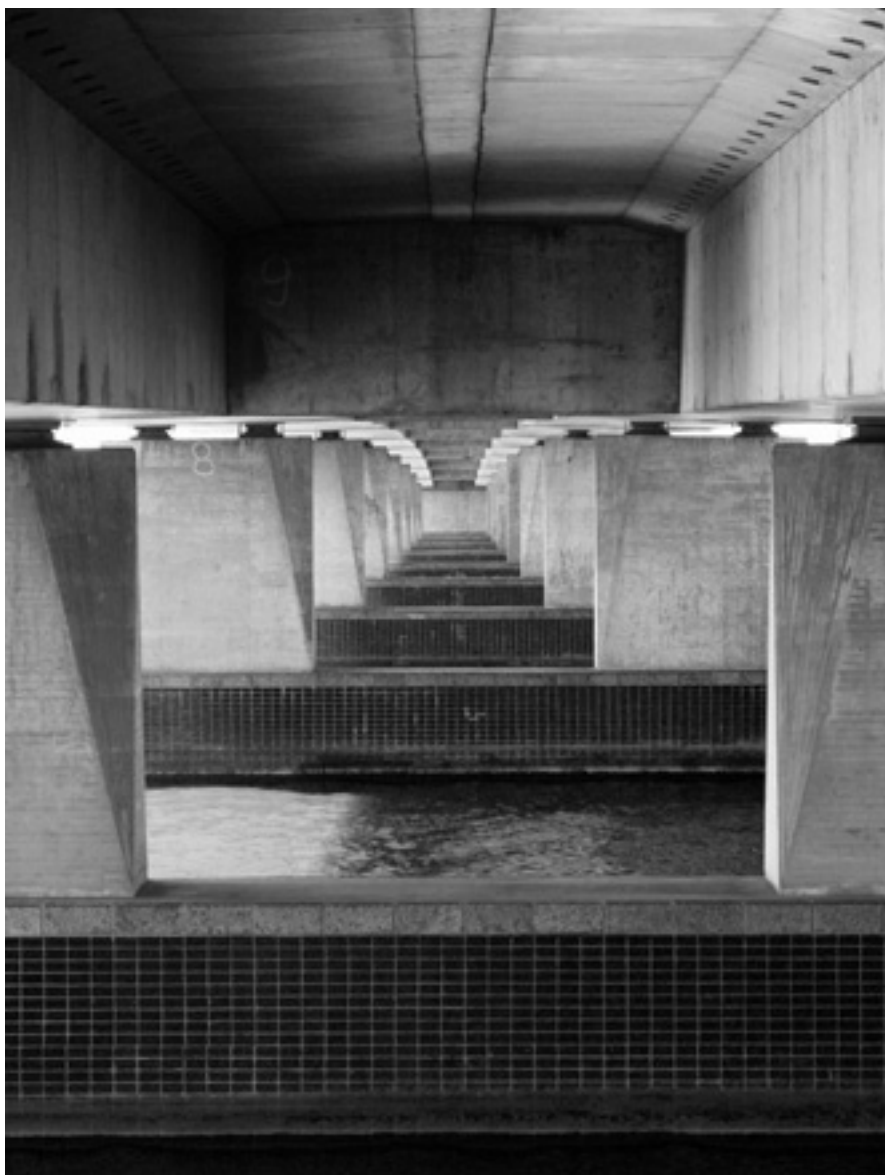
Beeld van de Ketelbrug zoals maar weinigen het kennen. Onderzoek heeft uitgewezen dat deze brug uit 1970 is versleten en moet worden vervangen.
